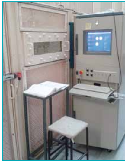
Vue du poste de travail et des équipements de protection collective mis en place.
